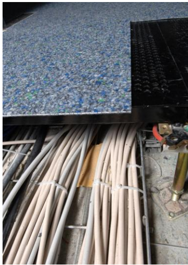
4: Versorgungskabel im Untergrund
